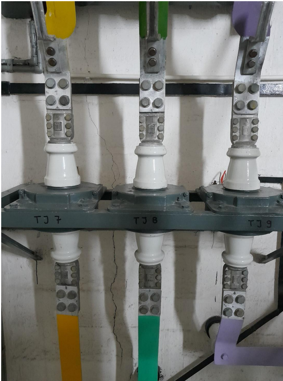
Przekładnik na odczpiecie generatora
