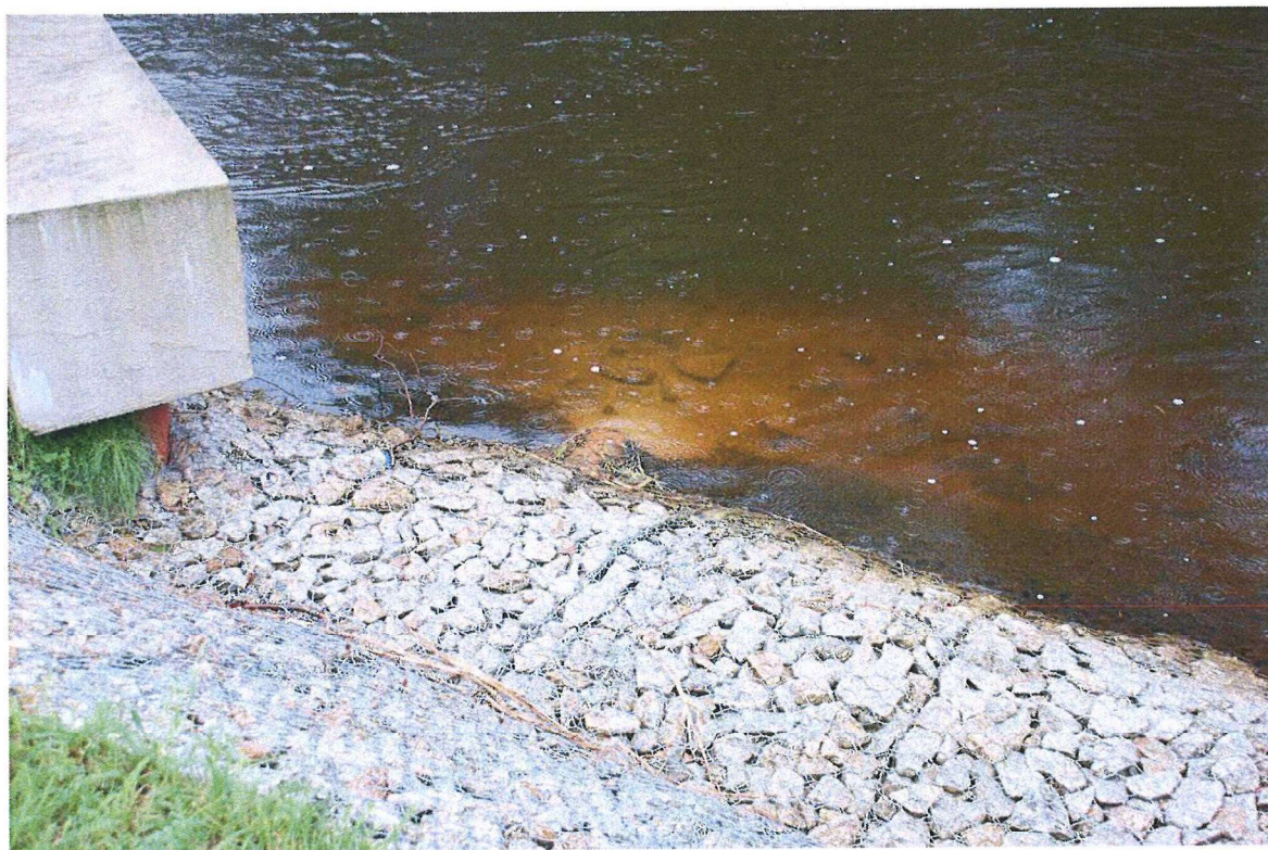
Fot. 6 – Wylot drenażu przy zakończeniu ścianki szczelnej - widoczny stożek usypowy z wyniesionego przez drenaż piasku.
