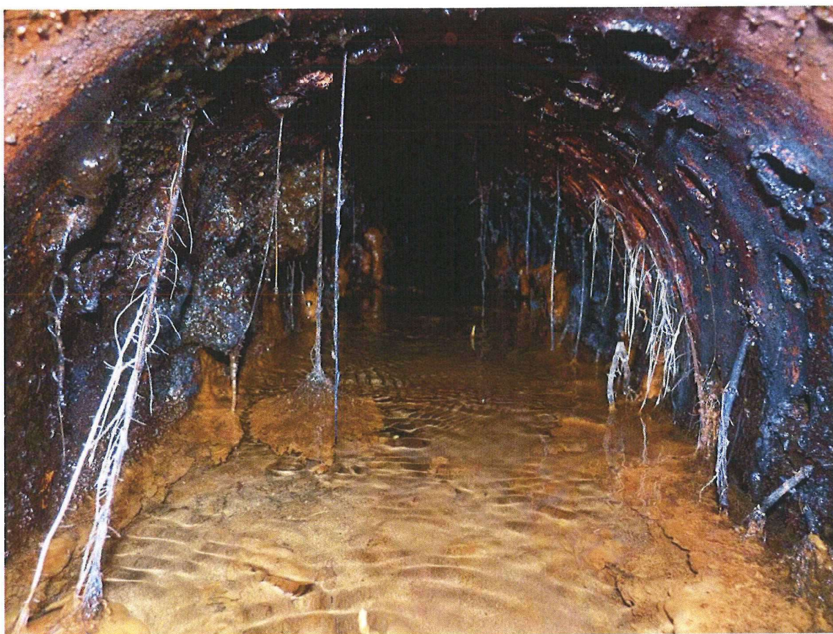
Fot. 2 – Rura drenażowa - widoczne zapiaszczenie przewodu i przerost korzeni.
