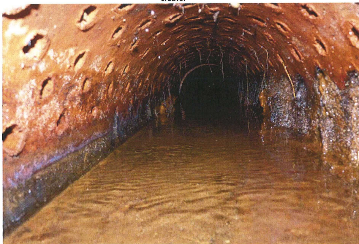
Fot. 4 – Rura drenażowa - widoczne zapiaszczenie przewodu.
