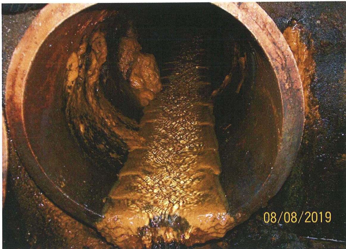
Fot. 5 – Rura drenażowa - widoczne związki żelaza wytrącone z wody gruntowej.
