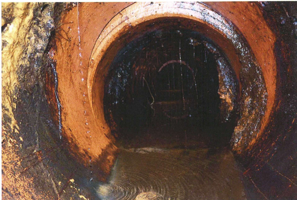
Fot. 3 – Rura drenażowa - widoczne kilkucentymetrowe przemieszczenia rur względem siebie.
