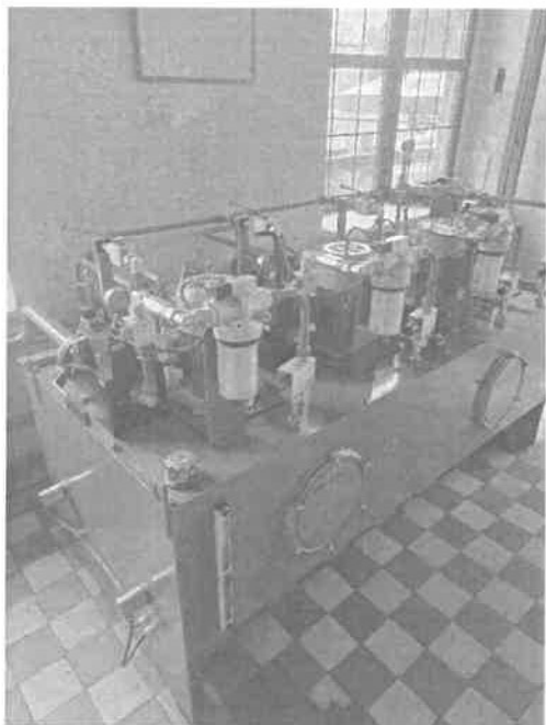
Rys. 1 Zasilacz hydrauliczny zasuw.
